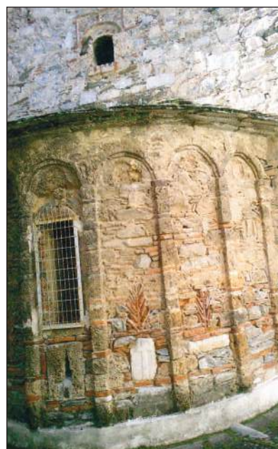
Η ανατολική όψη του ναού με την πρόθεση, με εντοιχισμένα παλαιοχριστιανικά ανάγλυφα
